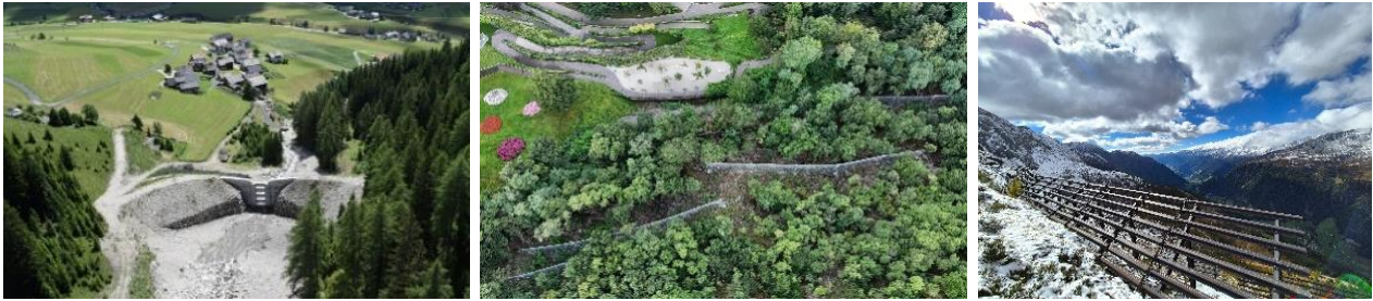
FIG.6: esempi di opere di mitigazione del pericolo. Da sinistra: briglia filtrante (Valle di Casies), reti paramassi (Merano, Trauttmansdorff), pontili da neve (Senales)
