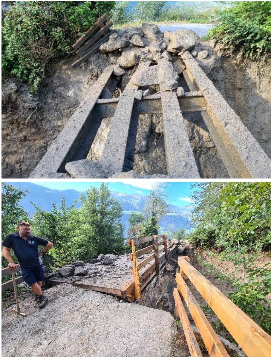
Figura 4.12: Danni agli attraversamenti: in corsi d'acqua con elevato trasporto solido l'occlusione è un fenomeno estremamente probabile, che va quindi sempre considerato sia nella valutazione del pericolo e nella progettazione di opere e manufatti
