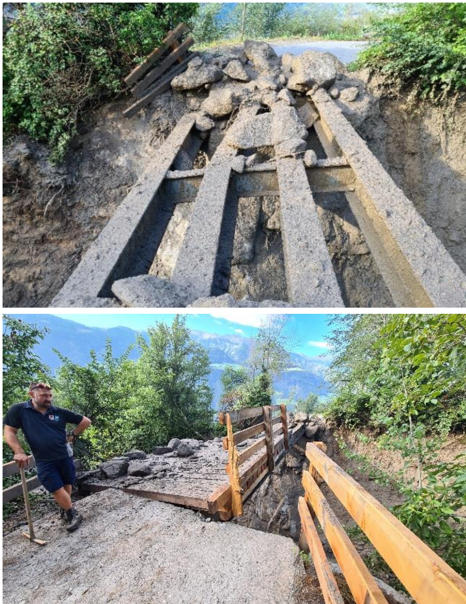
Abb 4.12: Verzeichnete Schäden an den Übergängen: In Fließgewässern mit hohem Feststofftransport kann es häufig zu einer Verklauung kommen. Die Bewertung dieses Risikos ist daher sowohl bei der Bewertung der Gefahr als auch bei der Planung von Bauwerken und Infrastrukturen stets zu berücksichtigen.
