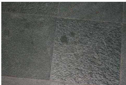
Macchie di grasso su pavimento in pietra naturale
