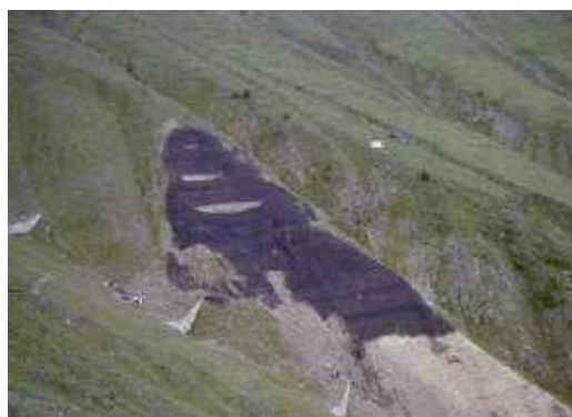
Fig. 82 Opere di drenaggio
