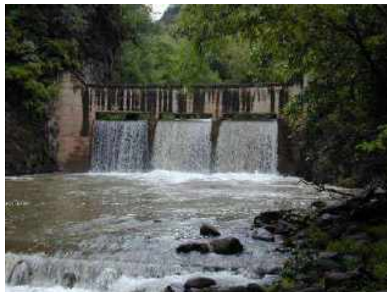
Fig. 29 Opera di regimazione delle acque
